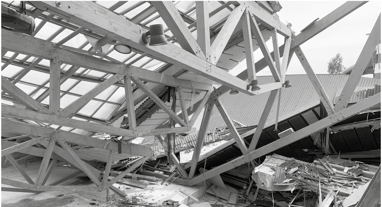
Eingestürzte Dachkonstruktion des Sportbades im „AquariUM“ Schwedt/Oder | Foto: Dr. Lutz Lehmann | BBIK
