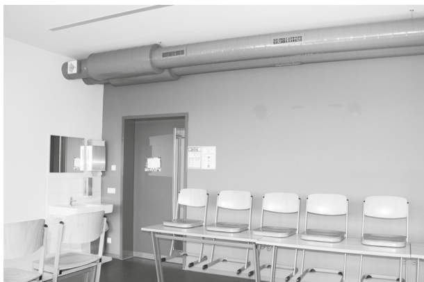
© Dr. Andrea Staar Lüftungsanlage in einem energetisch sanierten, denkmalgeschützten Schulgebäude
