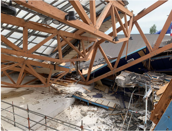
© Dr. Lutz Lehmann | Eingestürzte Dachkonstruktion des Sportbades im „AquariUM“ Schwedt/Oder
