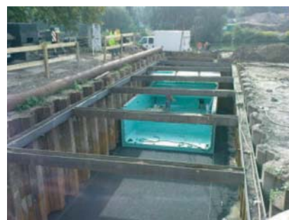
Neue RiStWag-Anlage an der Alten Fahrt
