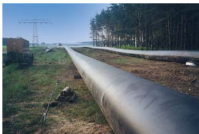
Sanierung von 3 Grubenwasserableitern Beton DN 1000 zur Tagebauentwässerung Bereich Schwarze Pumpe mit einer Gesamtlänge von 15 km durch Einzug von PE-Inlinern, Baujahr 2003
