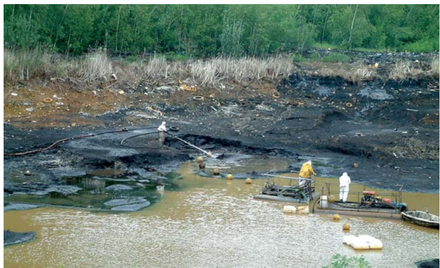
Für die Sanierung des Restloches 4 in Annahütte wurde durch das LMI über alle Phasen der Untersuchung, Planung und Sanierungsausführung die LMBV mbH gutachterlich und fachlich beraten.
